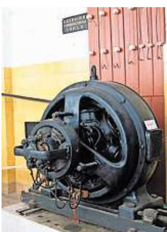
Im Generatorenhaus Kloster Veßra.
